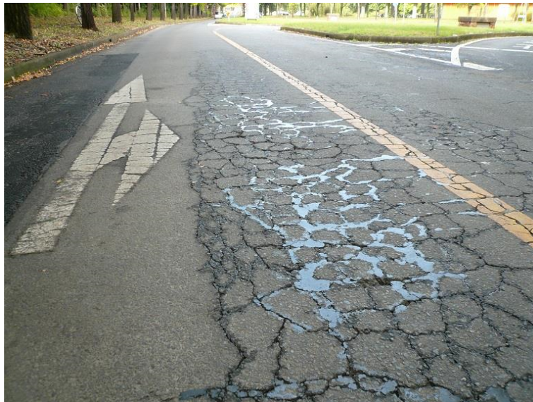
図 2.2: 路面損傷している道路
